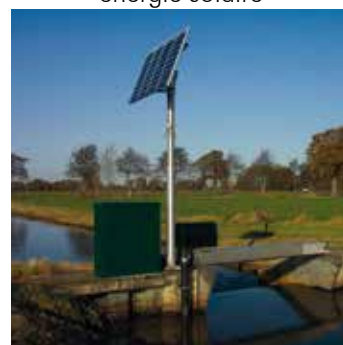
Alimentation servomoteur par énergie solaire
