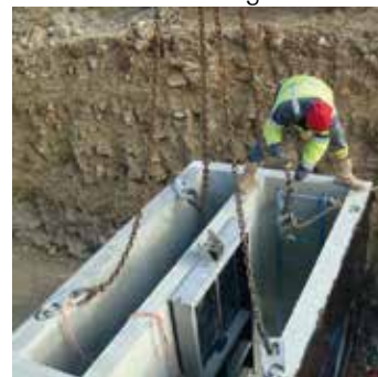
KSA dans regard
